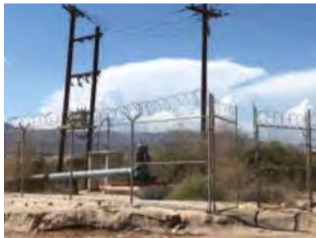
Figura 57 : Planta potabilizadora de agua "Cerro Prieto No. 6" en Colonia Seis (Granjas Lázaro Cárdenas).
